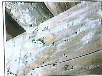
Photo n° PhTer001 Localisation : 2ème étage - Combles Ouvrage : Plafond - Charpente bois Parasite : Présence d'indices d'infestation ancienne d'autres agents de dégradation biologique du bois Indices : présence de trous de sortie, présence de vermoulure
